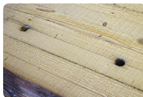
Aanwezigheid van gaten, scheuren en beschadigingen bij gerecupereerde elementen
