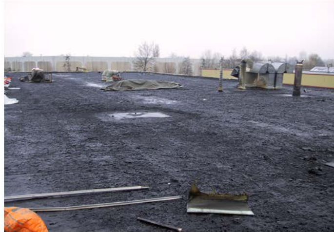
Toestand oude roofing (bitumineuze afdichting) na de brand
