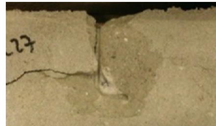
Figuur 129: Het spouwanker is door de mortel heen gesneden.
