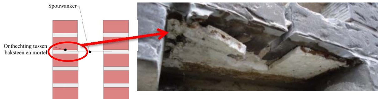
Figuur 10: Slechte hechting tussen mortel en steen waardoor de capaciteit van de constructie afneemt [BAR13].
