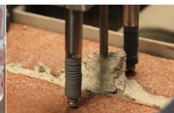
Figuur 83: Overtollig mortel op spouwanker
