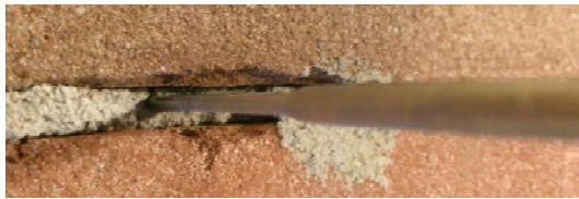
Figuur 136: Plaats van het spouwanker in de voeg. Dieper ingelegd dan 40 mm waardoor de spouwbreedte vergroot is en het hechtoppervlak verkleind is.
