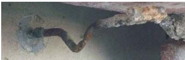
Figuur 6: Gecorrodeerd spouwanker gevonden tijdens inspectie. Bron: pbsvastgoed.nl
