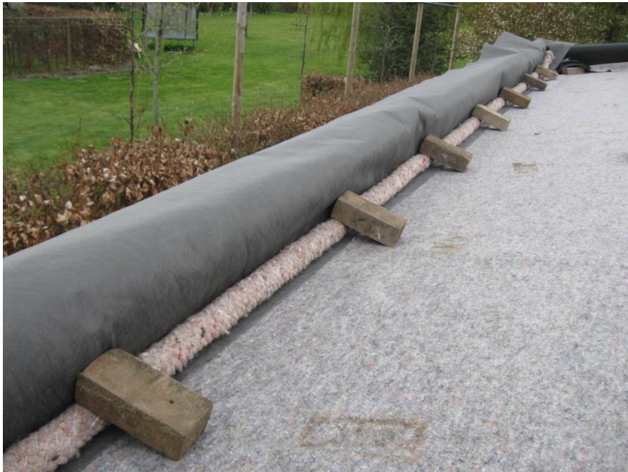
Drainagedarm op laagste punt
